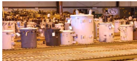
Foto: Transformadores con PCB
