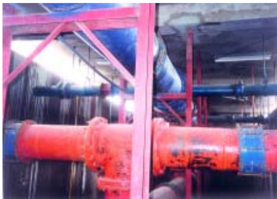
Figura 3-3. Galería de tubos convencional (3)
