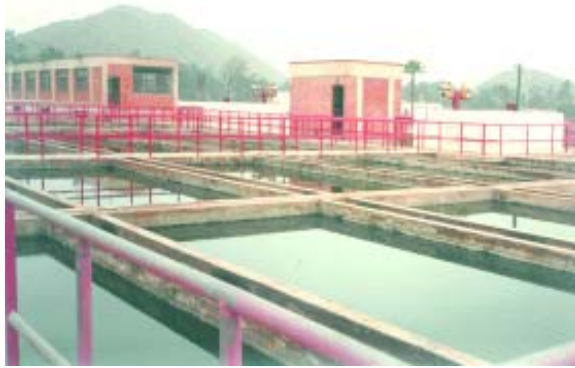
Figura 3-8. Decantador de manto de lodos (3)
