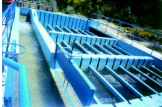
Figura 3-6. Floculadores hidráulicos de flujo vertical (3)
