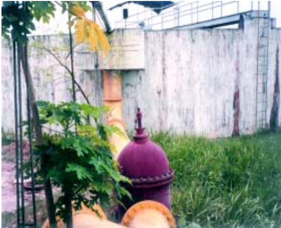
Figura 3-11. Unidad de manto de lodos averiada (3)
